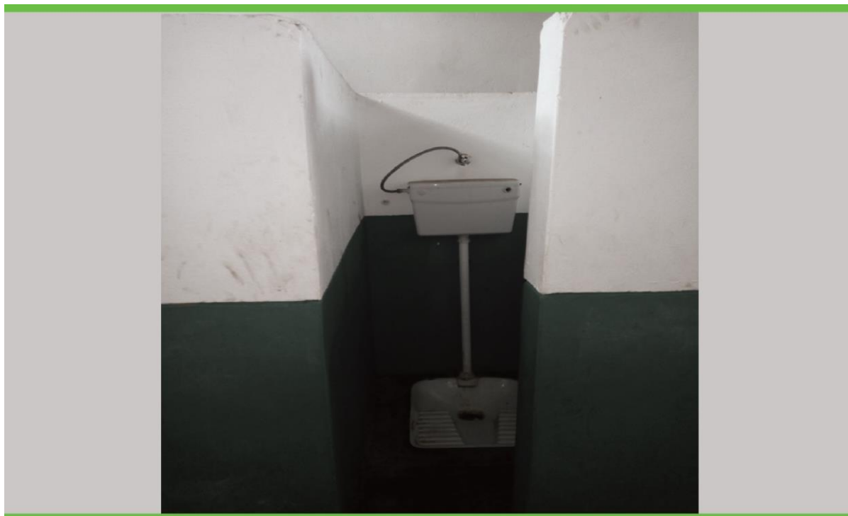
Figura 7: Ilustra a entrada apertada da casa de Banho da Escola Primária 25 de Junho (Rua 7)
